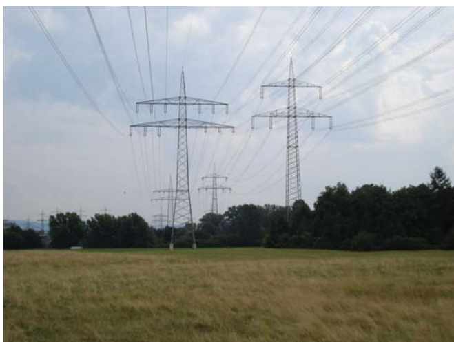
Abb.: 380-kV Freileitung 3024 und 220/110-kV-Freileitung 2007
