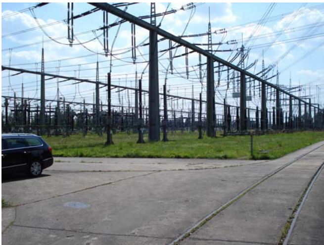
Abb.: 380-kV-Schaltanlage des Kraftwerkkomplexes
