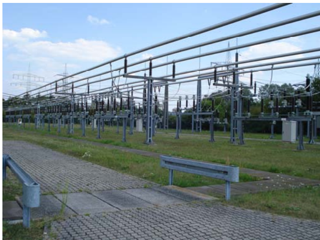
Abb.: 110-kV-Schaltanlage des Kraftwerkkomplexes
