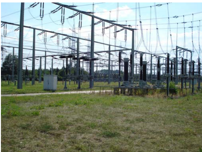
Abb.: 220-kV-Schaltanlage des Kraftwerkkomplexes
